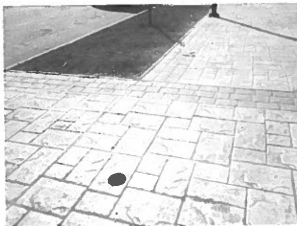
Foto N° 26 – Avenida Los Vilos Sur entre avenida Combarbalá y avenida Linares.
